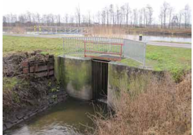
Bild 11 Einlaufbauwerk Düker Nr. 485 Intake structure culvert No. 485
